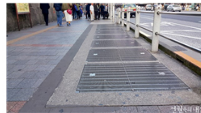
도교 우에도 보도에 있는 지하철 환기구를 보도높이와 완전 일치하게 하여 보행자에게 지장을 주지 않음
